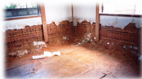
床上浸水の被害
